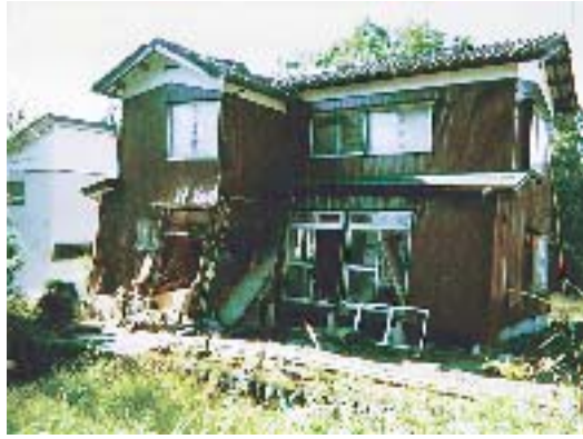
新潟中越地震における被災住宅
