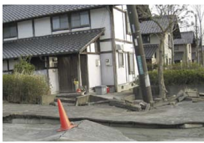
液状化の被害を受けた住宅(潮来市)
