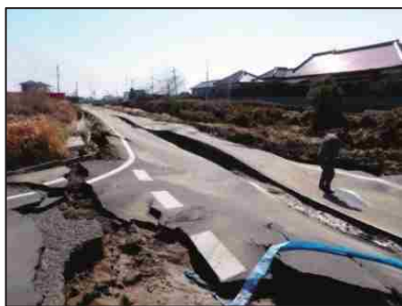
液状化による道路のうねり（鹿嶋市）
