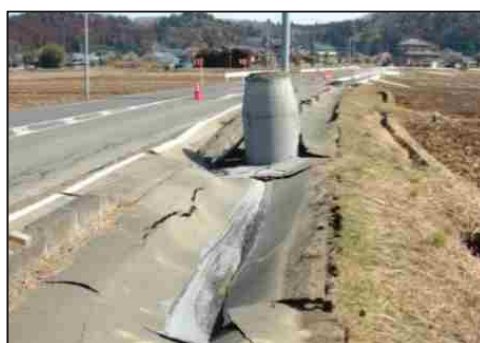
液状化によるマンホールの隆起（常陸太田市）
