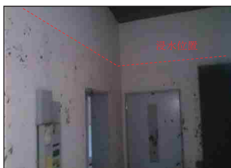
下妻ポンプ場 1階 浸水位置
