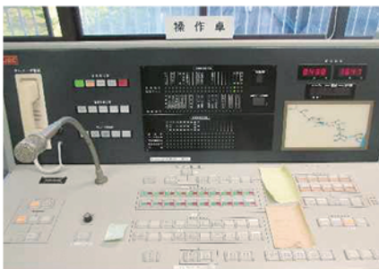
ダム制御処理設備
