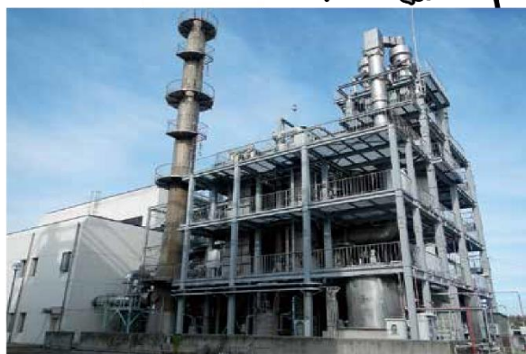
広域汚泥 1号焼却炉
