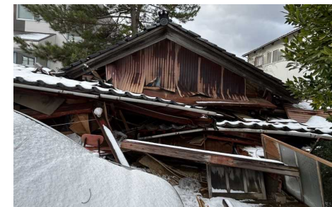
地震による木造住宅の被害
